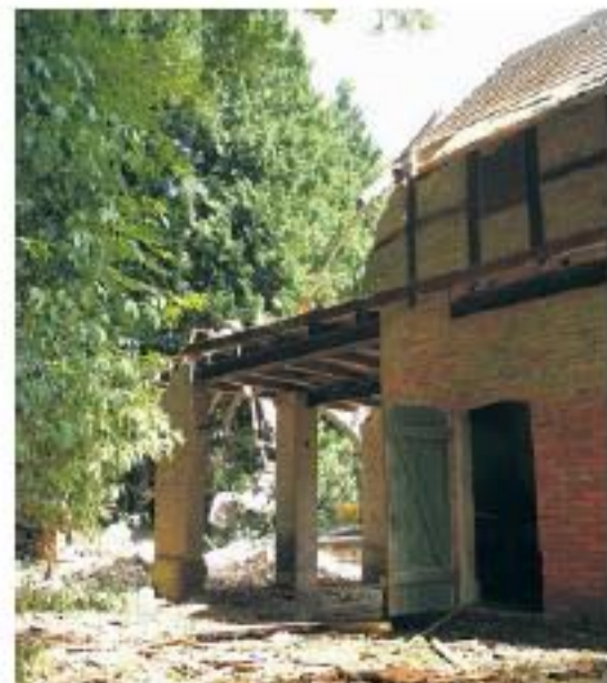
Erst wenn die Nebengebäude entfernt sind, kann man sehen, ob es dahinter Schäden am Mauerwerk gibt
