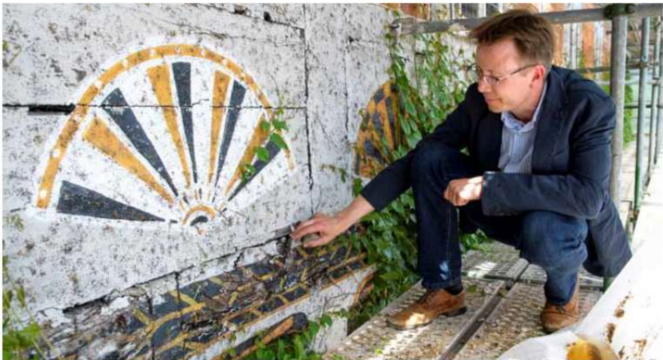
Eine lange Liste mit Schäden am Nordflügel des Elbschlusses in Bleckede hat Architekt Gunnar Schulze erstellt. Vor allem die Fassade muss dringend saniert werden. Foto: t&w
